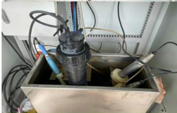
Các thiết bị kỹ thuật bên trong trạm quan trắc tự động
