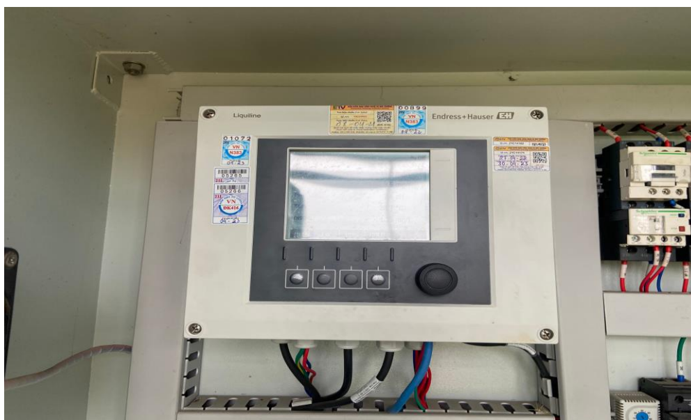
Hình 3. 11. Tem hiệu chuẩn 27/04/2022-30/04/2023 của các thiết bị trạm quan trắc nước thải tự động của KCN
